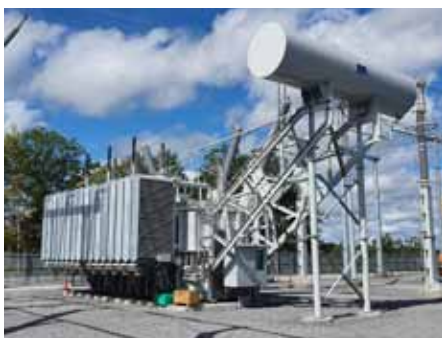
미국, 3상 500kV 350MVA
