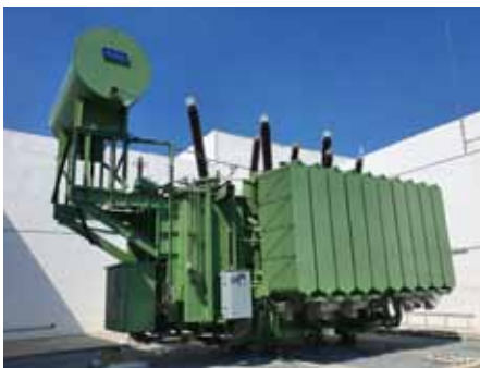
튀니지, 3상 225kV 200MVA
