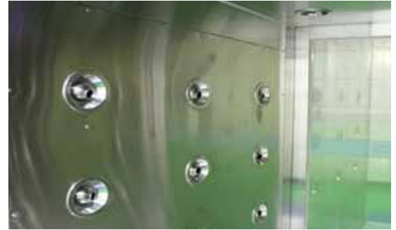
· 공기샤워기 작업장에 들어가기 전에 모든 사람은 Air Shower equipment를 통과해야 합니다.
