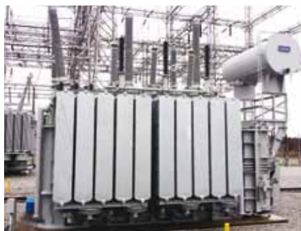
미국, 3상 345kV 448MVA
